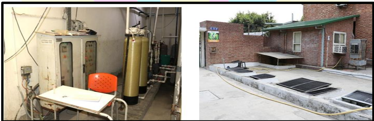
Fig. 11: Effluent Treatment Plant (ETP)
